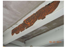
15. flaking paint 019.JPG
