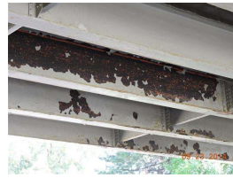
17. flaking paint 021.JPG
