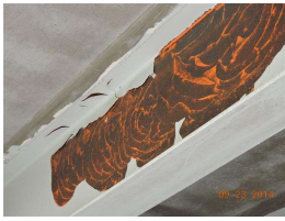
16. flaking paint 020.JPG
