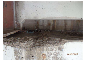
25. SW Abut Spall.JPG
