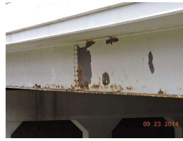
18. flaking paint 035.JPG
