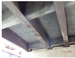
2. beam ends pier 4 - rusty.JPG
