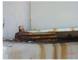
22. SE abut bearing anchor bolt 029.JPG
